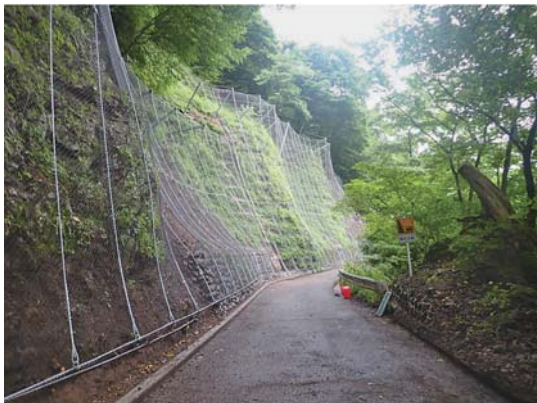
鋸山(大沢入)林道 (落石防止網工)
