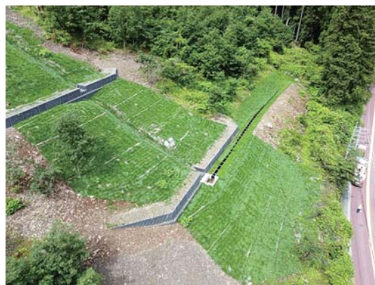
御岳災害関連緊急治山工事 (青梅市御岳一丁目) 工種：大型かご枠土留工・丸太柵工・伏工
