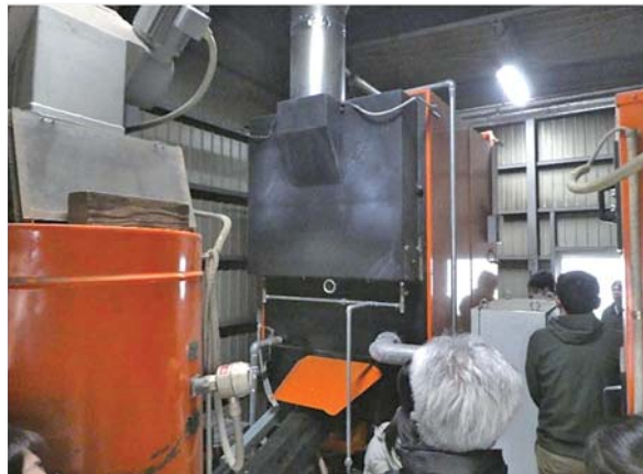
木質バイオマスボイラー施設
