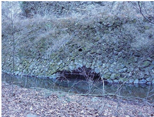
被災直後(入川林道)
