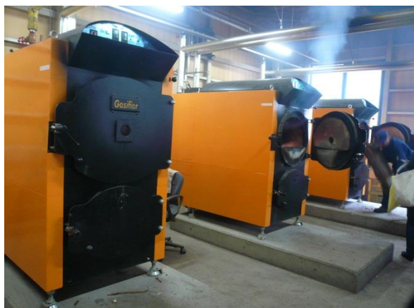
バイオマスボイラー（薪ボイラー）：山梨県道志村
