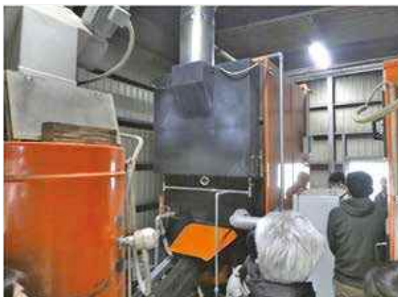
木質バイオマスボイラー施設
