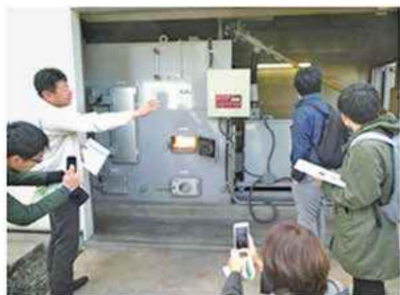
山梨市地域交流センターの木質ペレット冷暖房システムを見学
