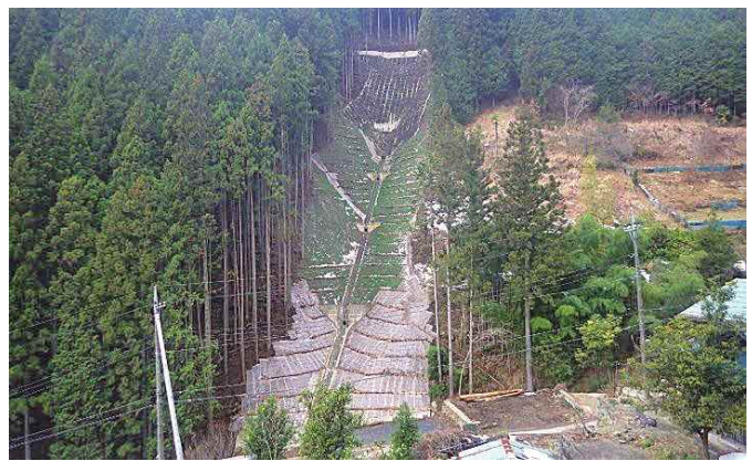
人里治山工事（その2） （土留工3基・護岸工L=18.0m） （法枠工A=1128.0 m 2 ・伏工A=1773.5 m 2 ） 木材使用量：11.6 m 3
