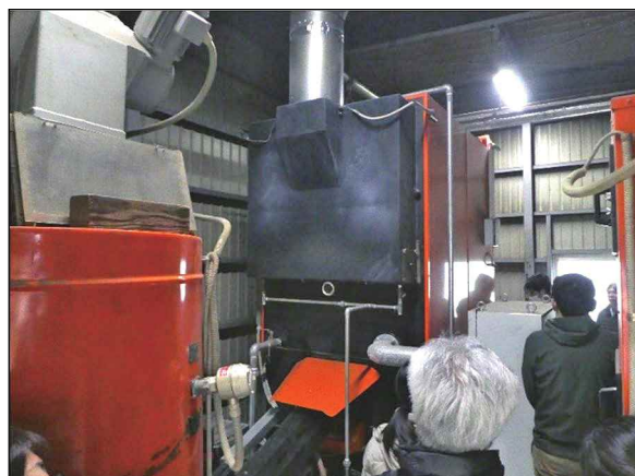
木質バイオマスボイラー施設
